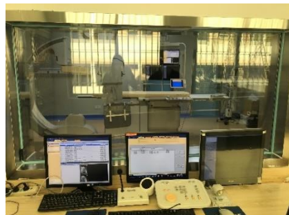
图 2-12 DSA 机房控制室
