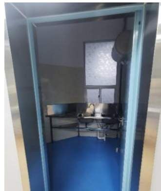
图 2-10 DSA 机房南侧污物间
