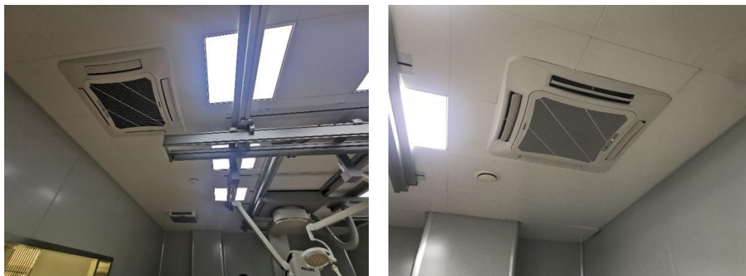
图 3-1 DSA 机房内空调
